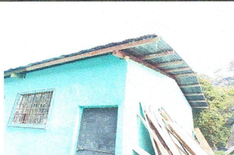
Foto 6: Estructura de techo de madera con presencia de humedad.
