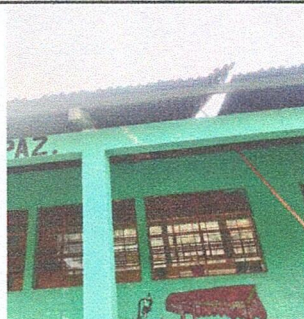
Foto 5: Vista paredes exterior de escuela con deterioro.
