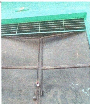
Foto 1: Porton del salon del Instituto con deterioro.
