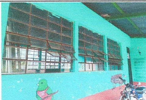
Foto 3: Vidrios de ventanas incompletos.
